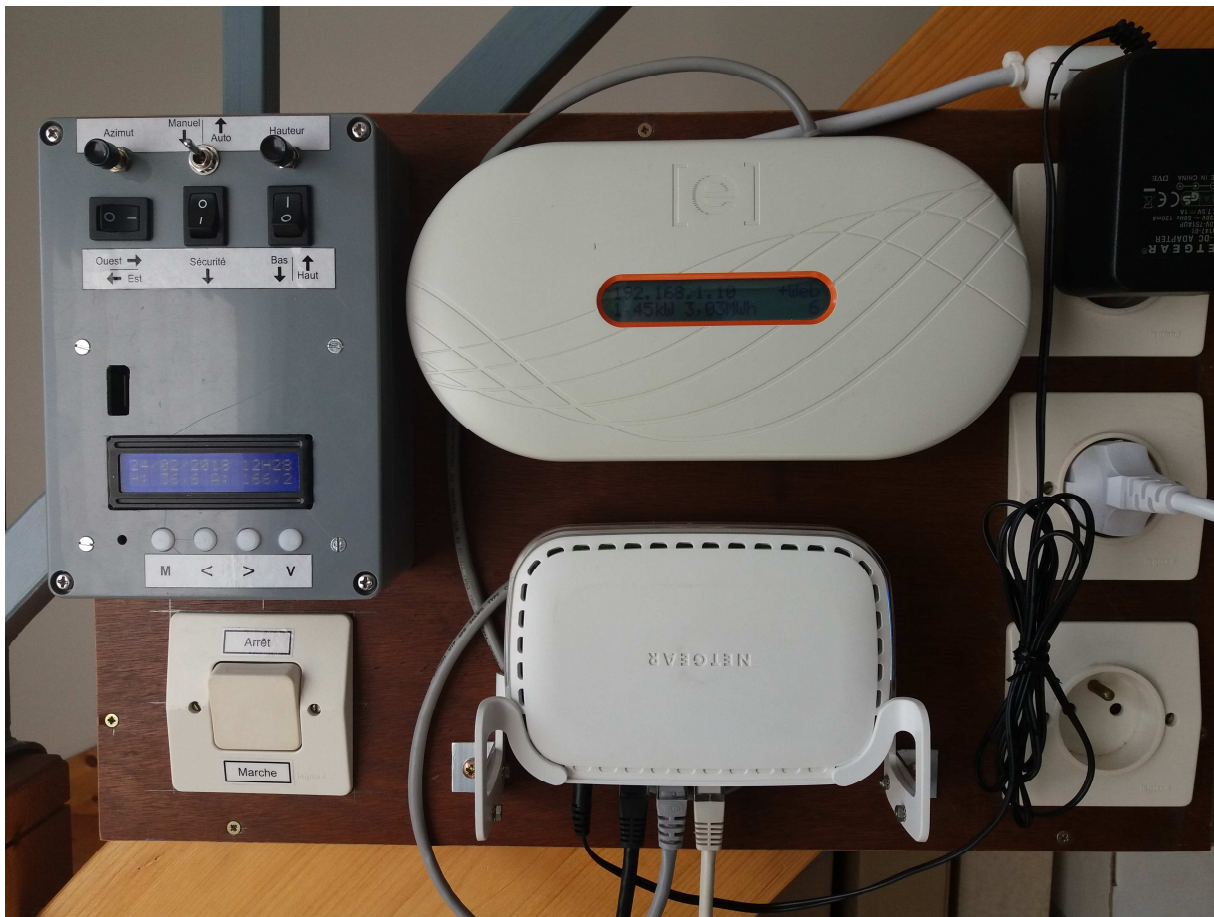
Figure 5 – 3 Tableau de contrôle et de commande
